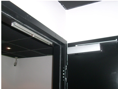
4. sz. kép: Tűzgátló ajtócsukó szerkezetének kiakasztása
